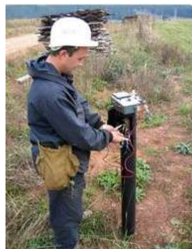
Контроль за потенциалом на трубопроводе
