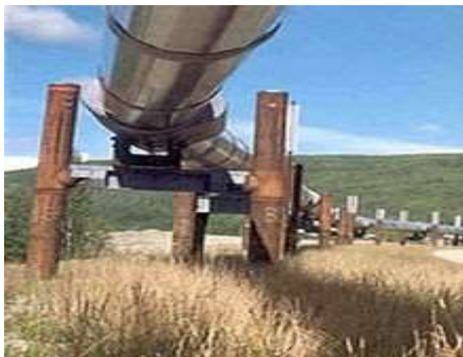
Надземная прокладка трубопровода по холмистому рельефу. Опоры трубопровода в виде стальных рам.
