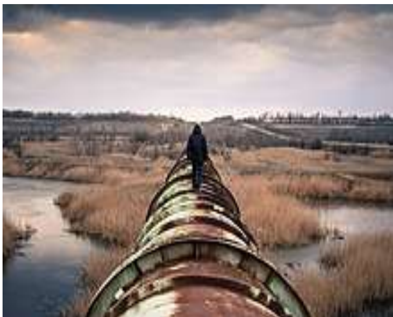
Переход трубопровода через реку с поперечными кольцами жёсткости.
