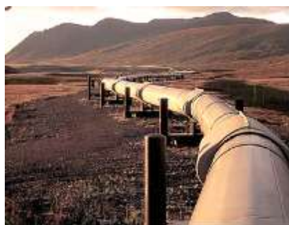
Магистральный нефтепровод ОАО «АК «Транснефть»
