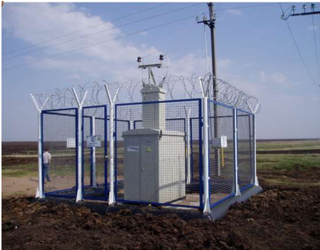
Станция катодной защиты
